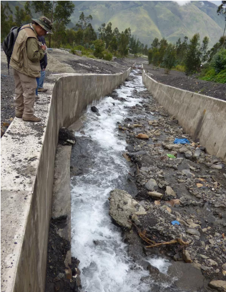
Figuras 10. Canalización de la quebrada Sahuanay construida en el 2014-2015 (vistas hacia aguas arriba y aguas abajo). Obsérvese como el agua viene erosionando las paredes del canal (fotos: Fluquer Peña, 2015).-/ Figures 10. Sabuanay stream channeling built in 2014-2015. Left picture: upstream; right picture: downstream. It is possible appreciate how the stream is eroding the bounds of the channel.
