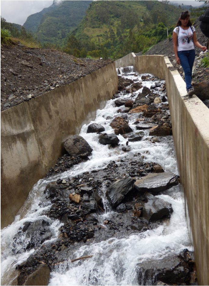
Figuras 11. Canalización de la quebrada Sahuanay construida en el 2014 - 2015 (vistas hacia aguas arriba y aguas abajo). Obsérvese como el agua viene erosionando las paredes del canal (fotos: Fluquer Peña, 2015)./ Figures 10. Sabuanay stream channeling built in 2014 - 2015. Left picture: upstream; right picture: downstream. It is possible appreciate how the stream is eroding the bounds of the channel.
